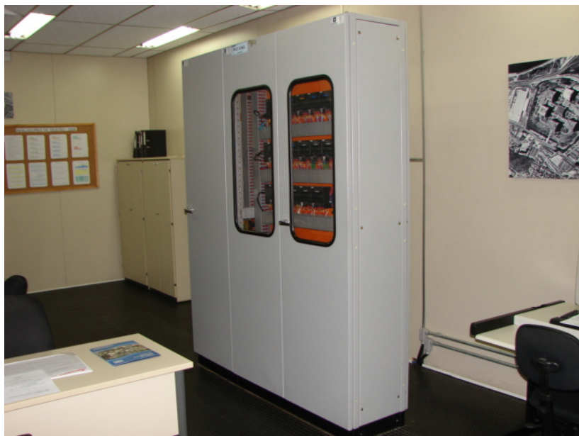
Figura 4.22 - Estação Controladora Remota da CAG
