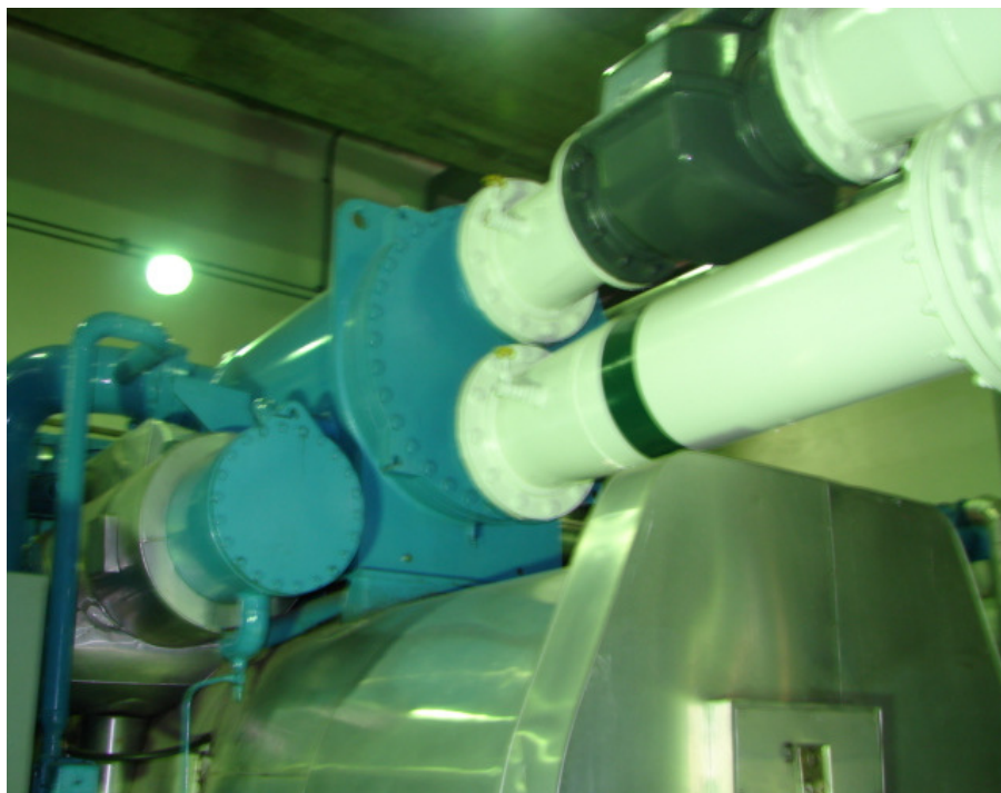
Figura 4.15 - Vista de chiller sem caixa Water Marine Box
