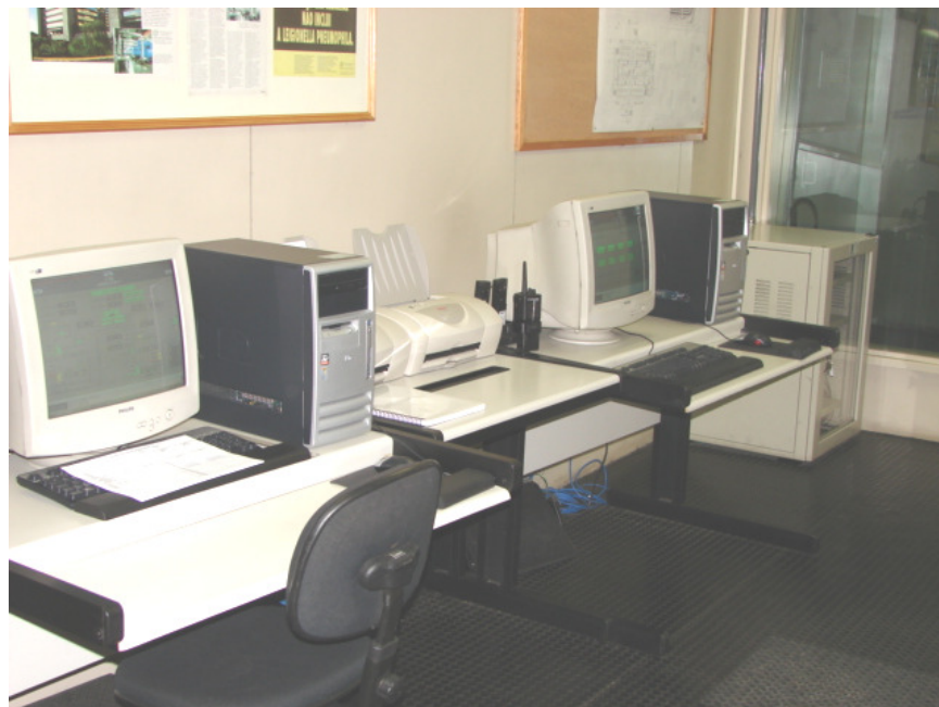
Figura 4.21 - Estação de Supervisão do Sistema de Ar Condicionado
