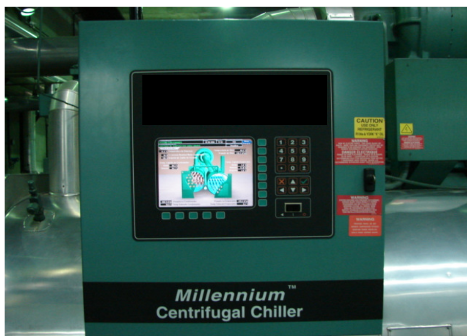
Figura 4.5 – Vista frontal externa do painel de supervisão e controle dos novos chillers
