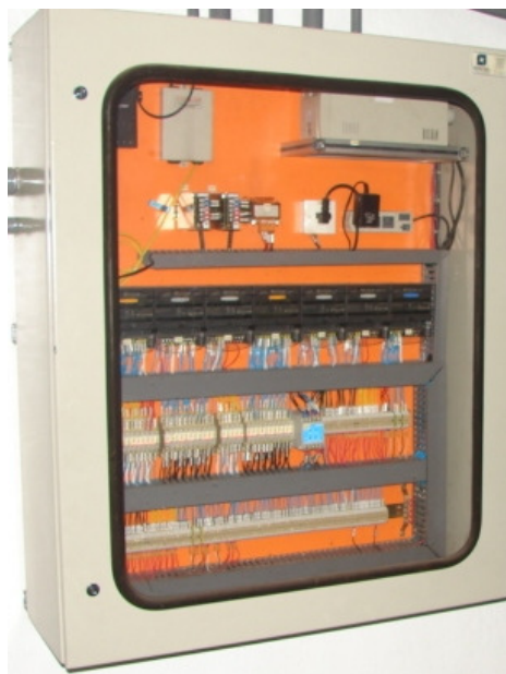
Figura 4.20 – Estação controladora remota
